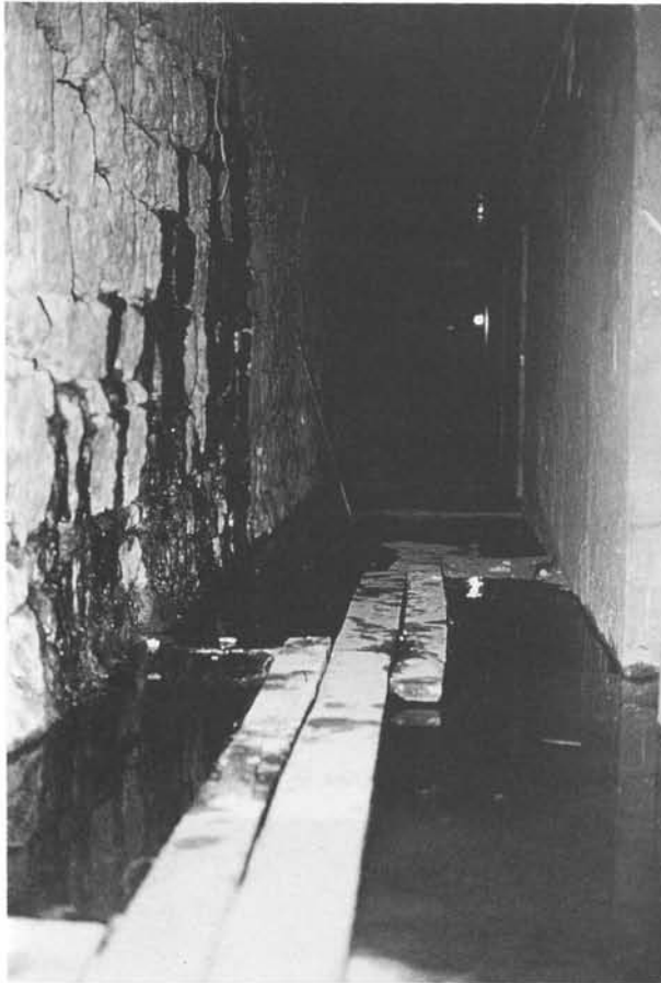
Fig. 6.—Humedades por capilaridad en la planta semisótano de la galería Este.
