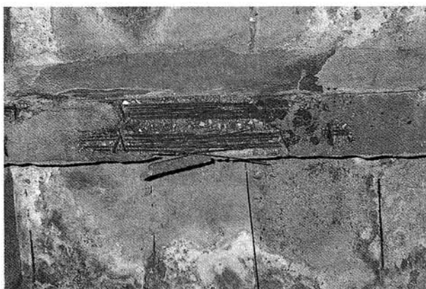
Foto 2.—Detalle de corrosión de las armaduras.
