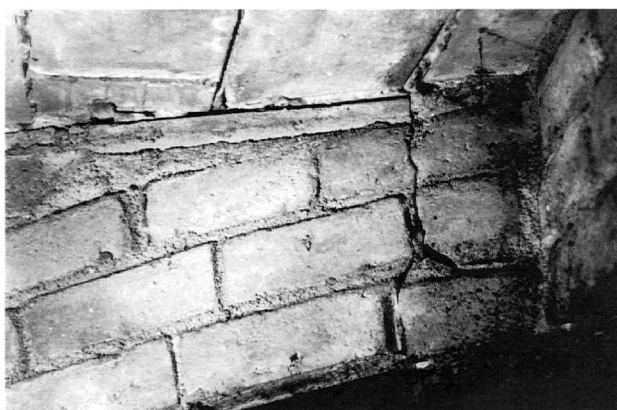
Fig. 6. Rotura de una de las costillas en su entrega con la riostra longitudinal.
