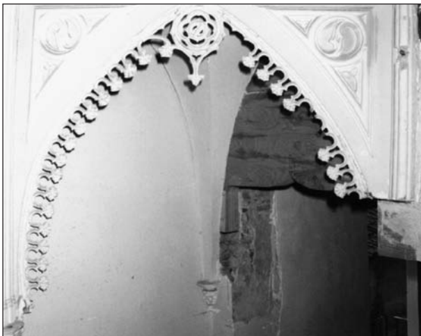
Foto 5.- Fractura del muro.
