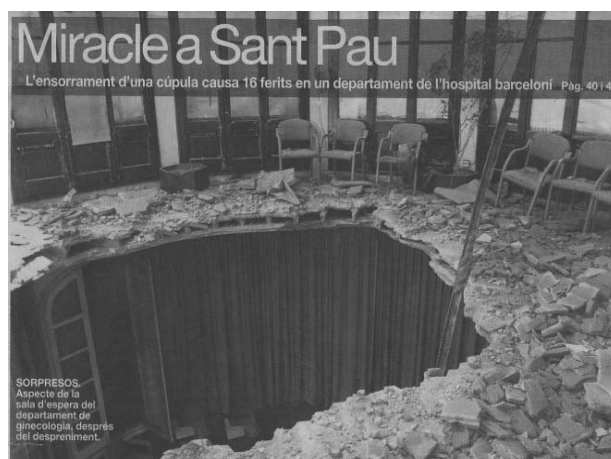
Figura 3.- El título es bien expresivo: Milagro en Sant Pau. La cúpula (que no se ve en la fotografía) cayó sobre la bóveda (cuya “sección” quedó bien visible), suelo de la sala de espera y techo del sótano.
