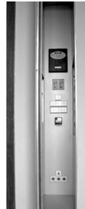
Figura 8. Armario de instalaciones.
