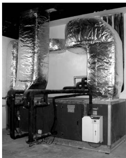
Figura 23. Sala del climatizador modular 1.
