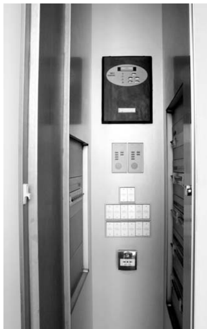
Figura 17. Armario con control de escenas.
