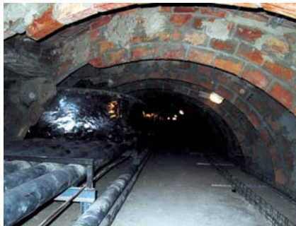
Figura 21. Redes de tuberías por cámaras de cubierta.
