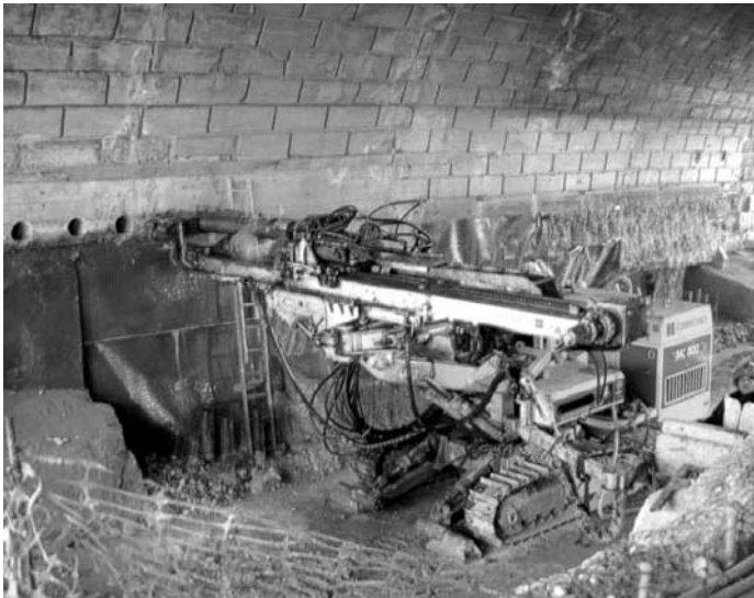
Ejecución de inyecciones de consolidación de una pila del Puente de Segovia.
