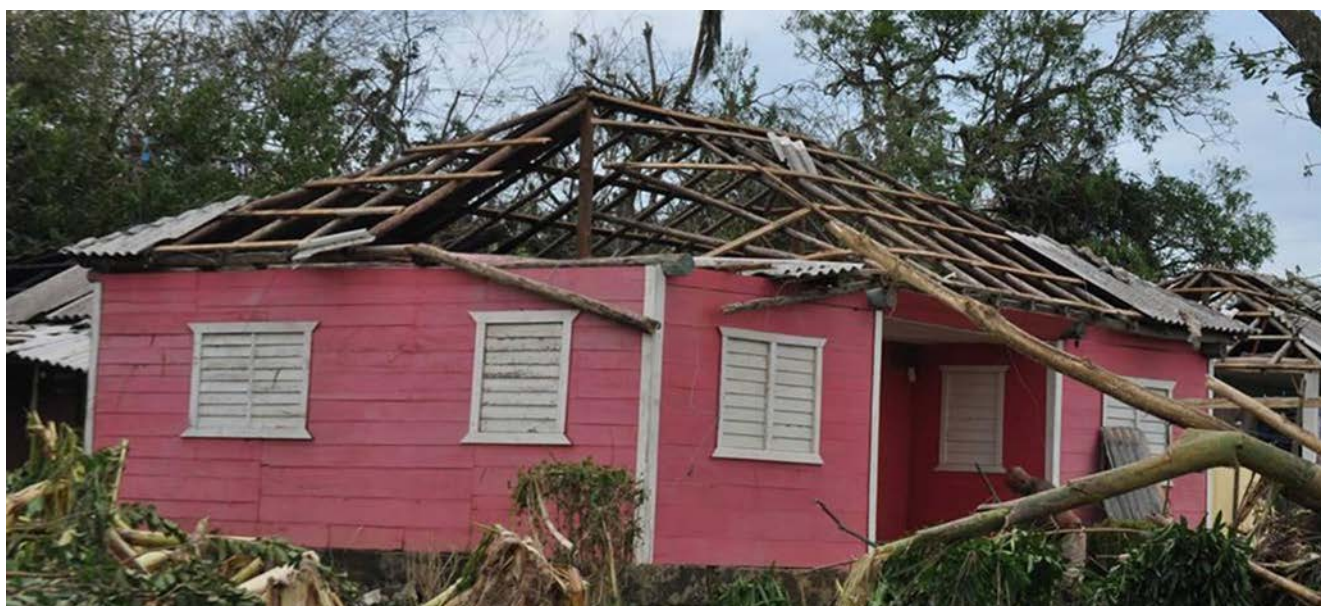
Figura 1. Impacto de los huracanes sobre las cubiertas ligeras de fibrocemento en las provincias del oriente cubano.
