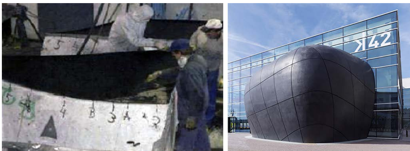
Figura 2. Moldes de EPS sobre los cuales se proyectó GRC con colorante negro. Proyecto Medienhaus K42, Friedrichshafen (2002) Matthäus Schmid
