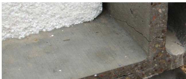
Figura 3. Placa acopiada en la planta con fisura en un nervio.
