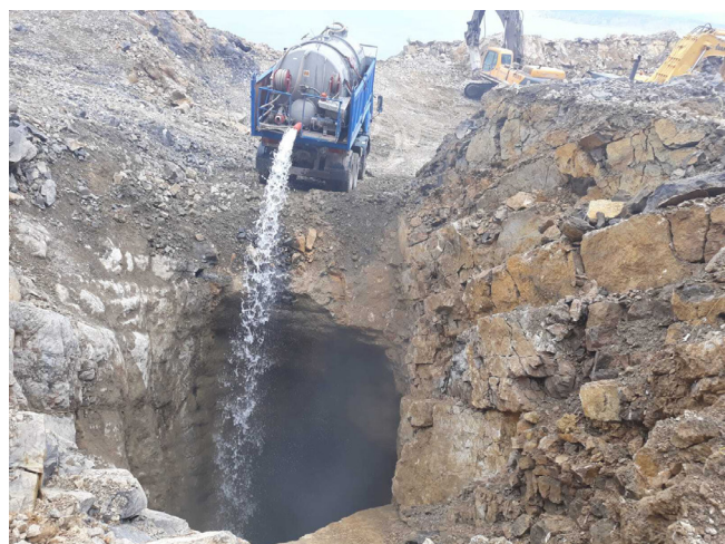
Figura 17. Vertido de agua desde la cabeza superior del pozo subvertical
