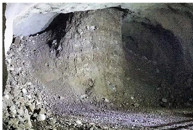
Figura 16. Detalle de apelmazamiento en el final del pozo por existencia de finos cohesivos
