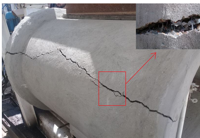
Figura 6. Patrón de fisuración Longitudinal del tubo.
