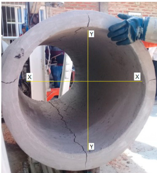
Figura 5. Patrón de fisuración en la sección transversal del tubo.
