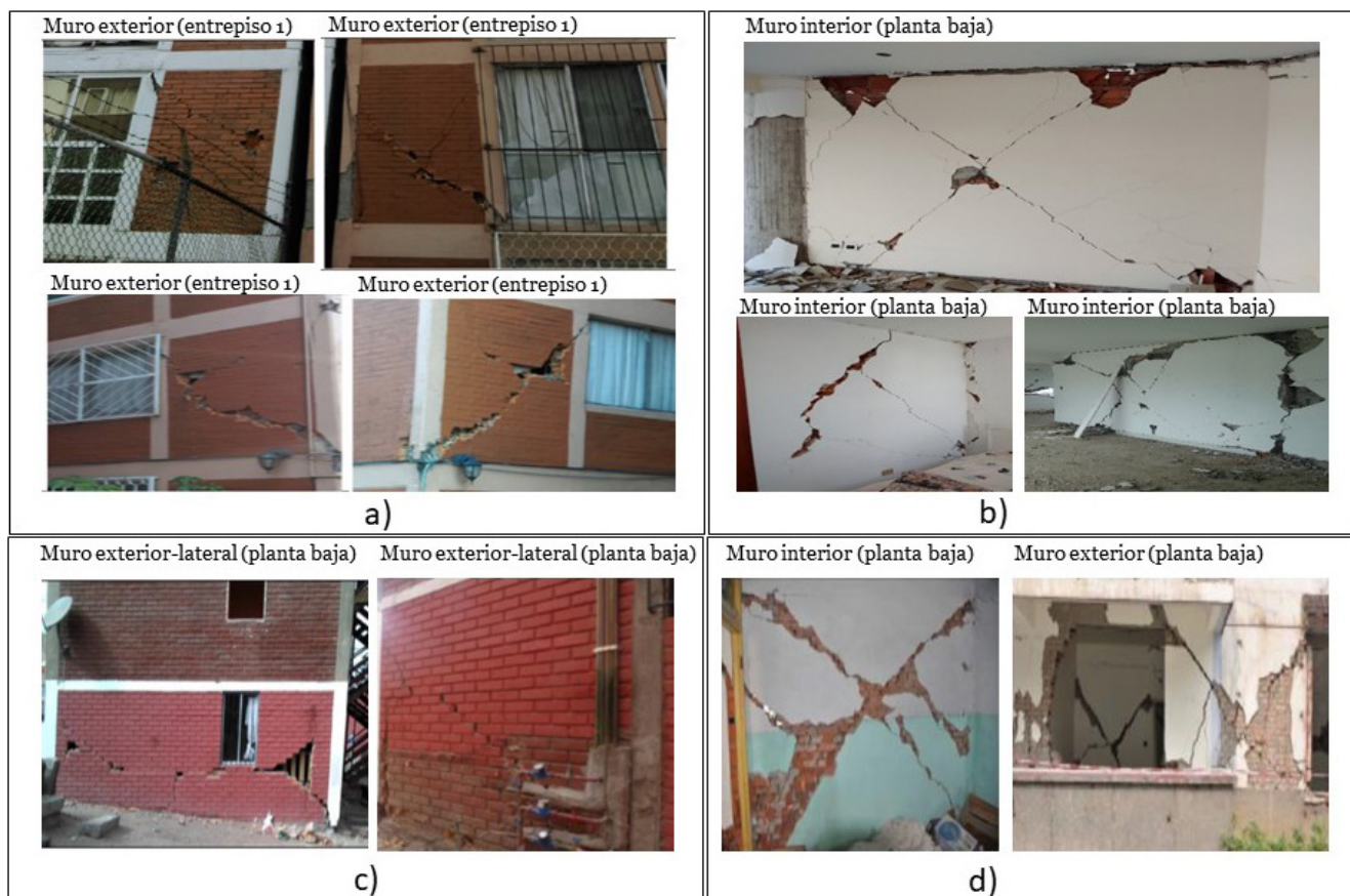
Figura 1. Daños en mampostería confinada por tensión diagonal: a) Edificios departamentales en Ciudad de México (México) (6), b) Hoteles en Bahía de Caraquez (Ecuador) (7), c) Edificios conjunto las Dunas Iquique (Chile) (8) y d) Edificios residenciales en Wenchuan (China) (9).
