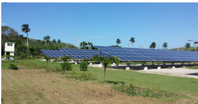
Figura 2. Parque solar fotovoltaico en Cuba (prototipo)
