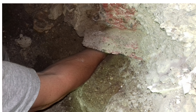
Figura 10. Apoyo descalzado bajo placa de anclaje.
