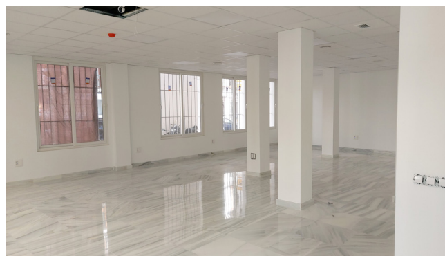
Figura 36. Trasdoso interior y nuevas carpinterías.
