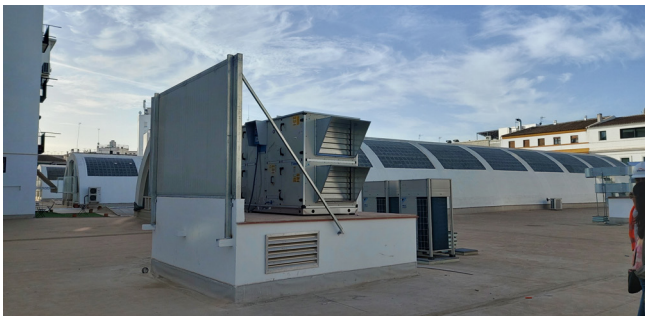
Figura 38. UTA en cubierta y barrera fonoabsorbente.
