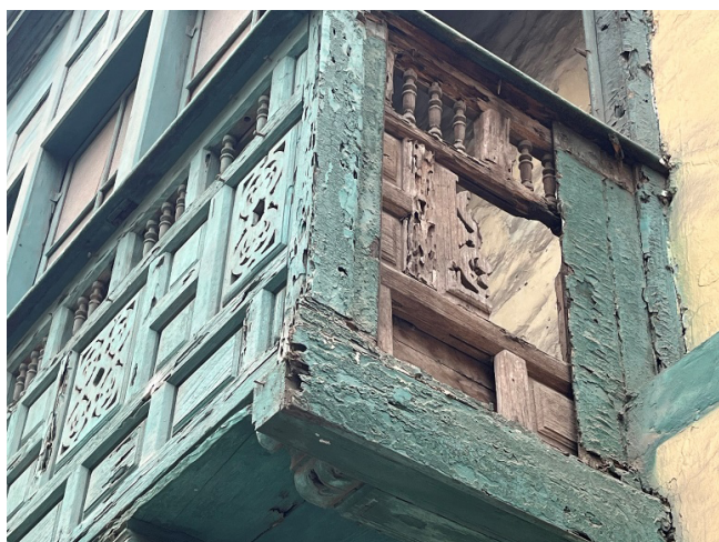
Figura 6. Balcón de cajón cerrado con reparaciones posteriores, cubriendo con tableros los balaustres originales del antepecho, y ménsula que oculta el can original (Foto de los autores).
