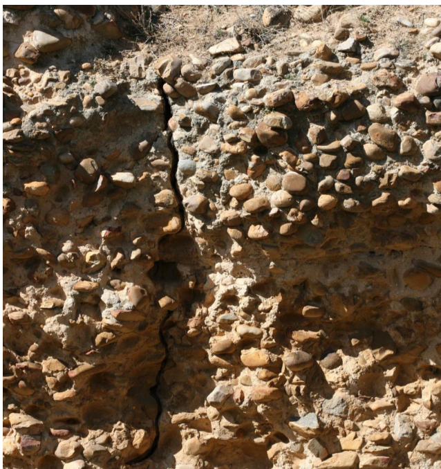
Figura 11. Fisuras en el lienzo oeste
