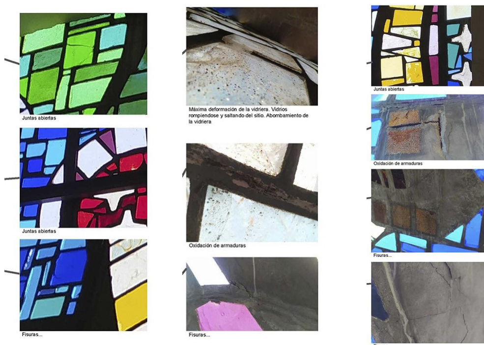
Figura 6. Estado previo de la vidriera. Deformaciones y fisuraciones
