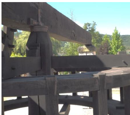
Figura 25. Pilar central de la noria de Allariz. Obsérvese el sistema de anclaje con la viga secundaria
