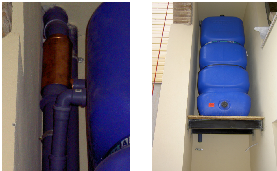
Figura 2. sistema de recogida y almacenamiento del agua de lluvia. Fuente: autores
