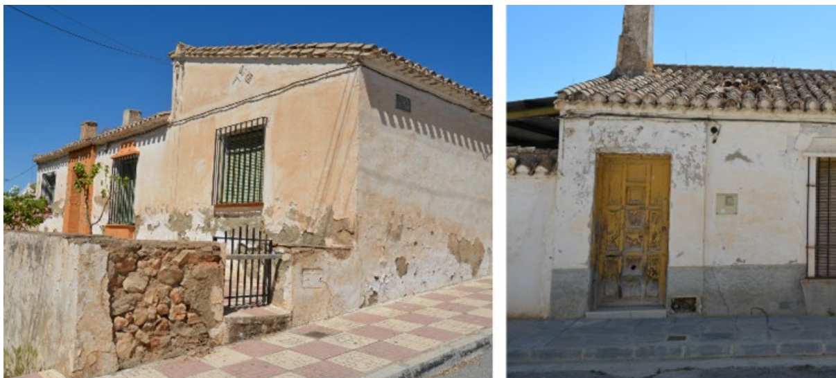
Figura 7. Patologías detectadas en Fuensanta (Pinos Puente) y Buenavista (Alhama de Granada). Fotografías de los autores.
