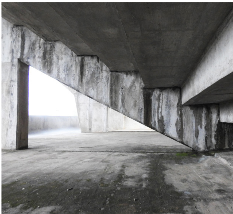
Figura 16. Pasaje de agua entre los elementos de hormigón armado y comienzo de acumulación en planos horizontales a partir del inicio de una tormenta de lluvia y vientos intensos
