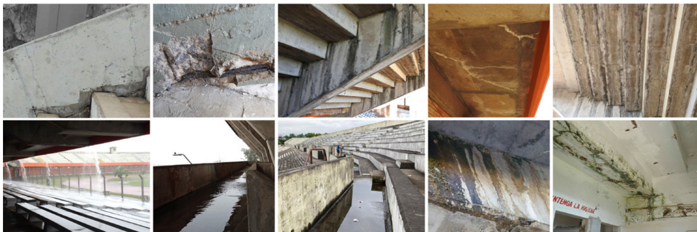
Figura 9. Lesiones y problemas constructivos observados en los relevamientos realizados en el Estadio. Años 2022 y 2023
